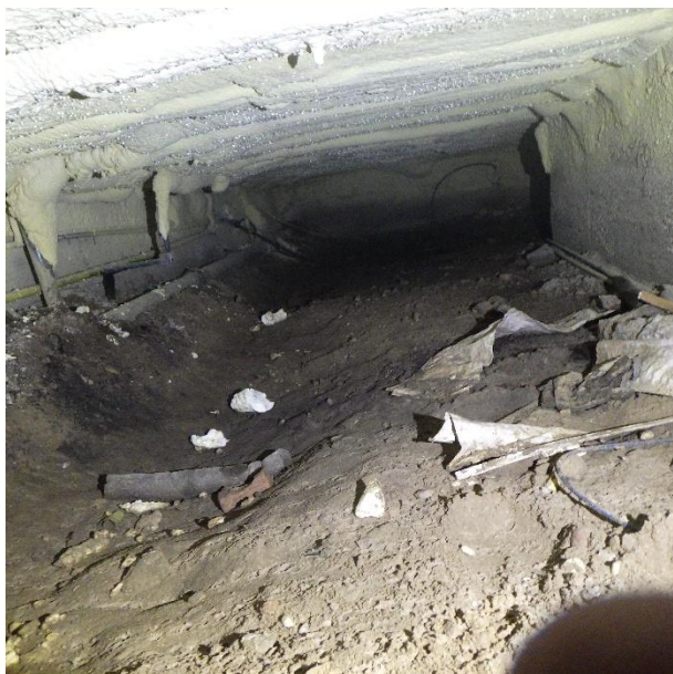
Foto 06: Kruipruimte; Tijdens de inspectie waren er condensdruppels aanwezig onder de vloerconstructie.
