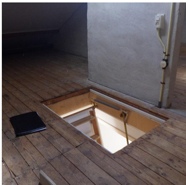
Foto 04: Zolder; Er is geen traphek aanwezig rondom de vloeropening.
