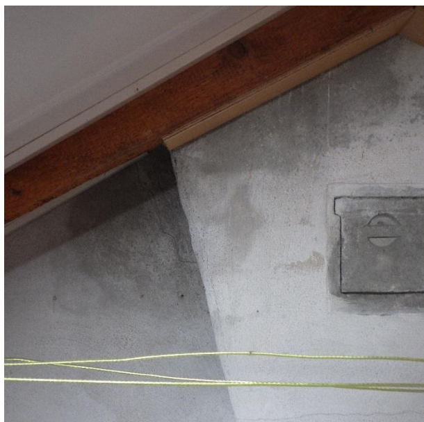
Foto 01: Onderzijde hellende dak; Bij beide schoorstenen zijn aftekeningen van opgedroogd vocht zichtbaar.
